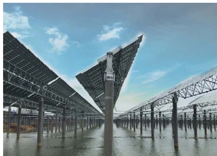
华东院天长 140MWp 渔光互补光伏发电项目
